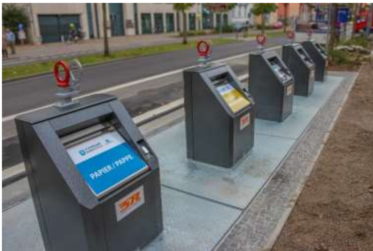
Unterflursystem der Wohnanlage „Am Rosengarten“, Rostock a)
